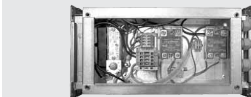
Рис. 12 – вид на электрощит обогревателя EOS
